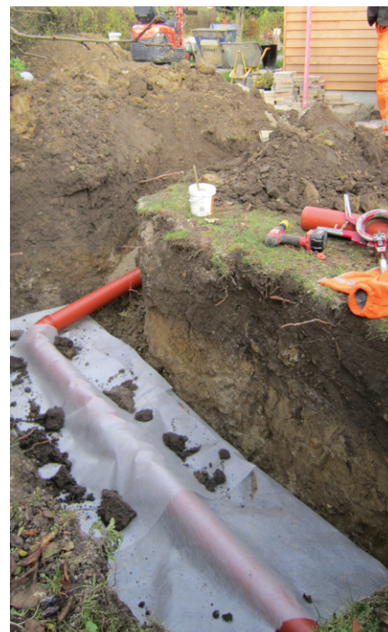
Figur 15: Faskine under udførelse. Faskinen er blevet pakket ind i geotekstil, som forhindrer den omkringliggende jord i at trænge ind i faskinen. Regnvandet ledes til faskinen via det orange rør. Lindevang i Brøndby. Foto Spildevandscenter Avedøre.
