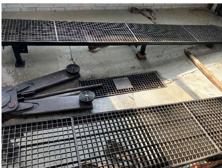
Foto 5: Gulvrist i rum til effektmålinger (HK, hastighed). Rummet har tidligere været brugt til vaskerum og dernæst til undervognsbehandling.
